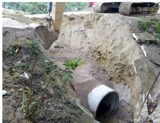
Fotografía: Alcantarillado Pluvial en Melchor Ocampo 3ra sección.
