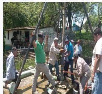
Fotografía: Instalación de bomba y motor en cisterna de rebomdeo
