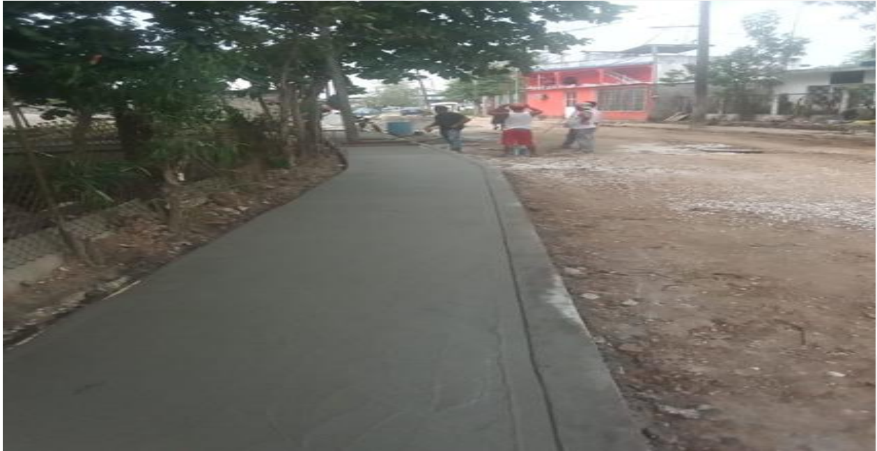
Fotografía: Construcción de guarniciones y banquetas en Colonia Belén, calle acceso a la Dirección de Seguridad Pública. Monto: $467,346.15
