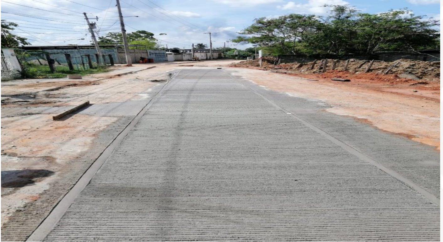
Fotografía 2/2: Rehabilitación Del Colector General De Drenaje Sanitario En Colonia La Unión Carretera Principal. Monto: $ 2,748,314.86
