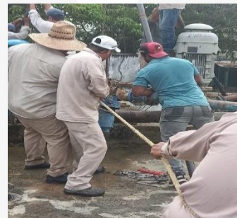
Fotografía: Mantenimiento a bomba de 19 pasos
