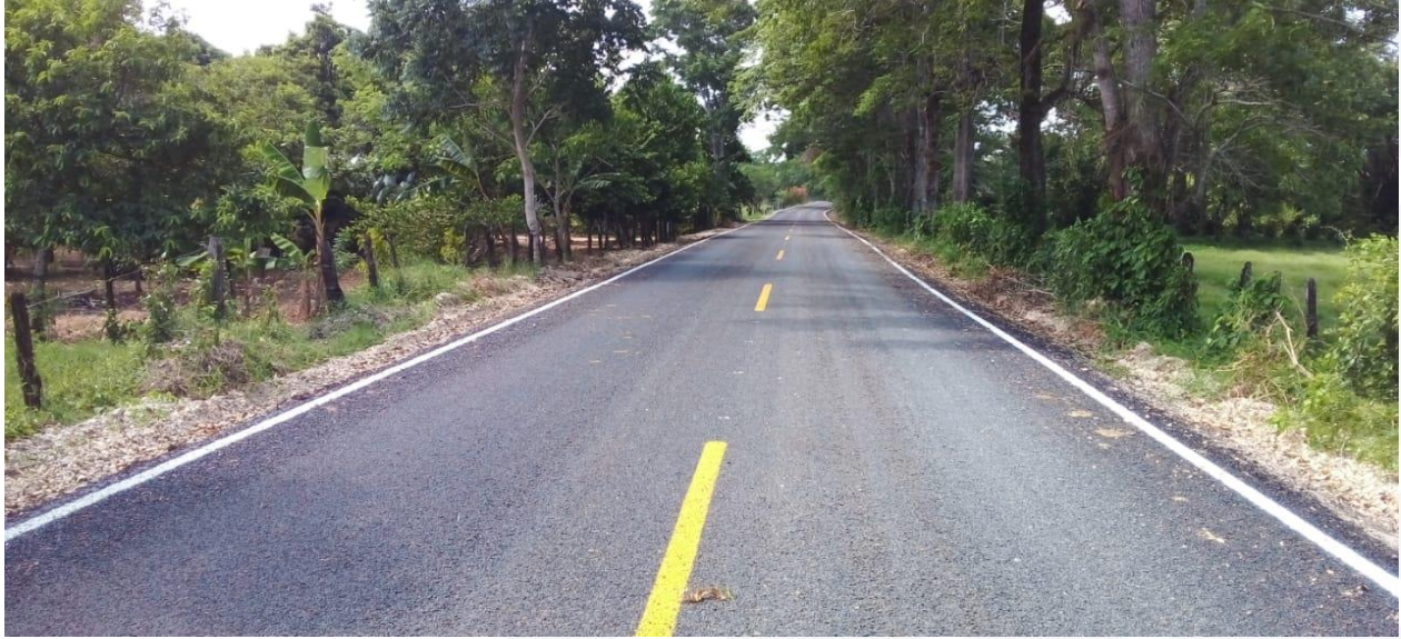
Fotografía: Construcción de Camino con mezcla asfáltica en caliente en Ranchería El Triunfo 3ra Sección. Monto: $5,293,953.12
